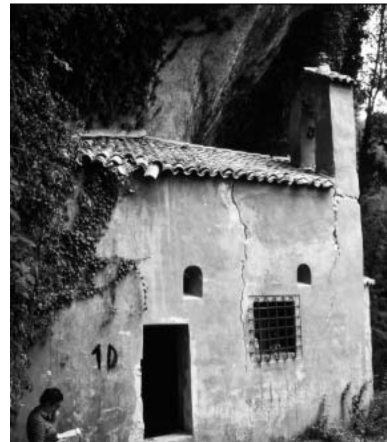
Id., documentazione del quadro fessurativo, superficie esterna della parete ds., marcata con la lettera "D" nel corso di precedenti sopralluoghi.
